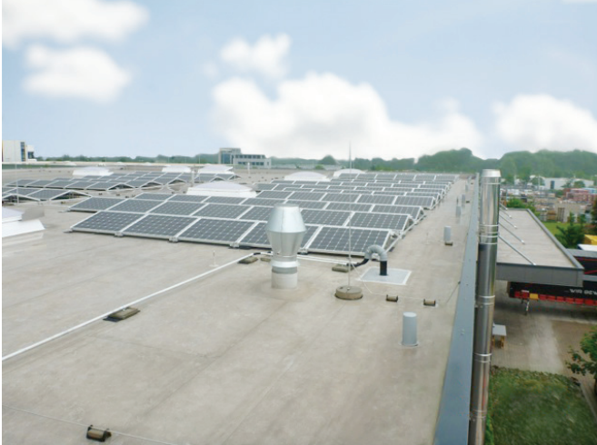
Photovoltaic installation ADL in Amt Wachsenburg (Erfurt).
